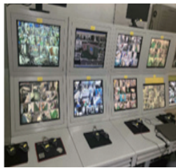
防災監視センター点検
