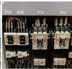
電気設備点検
