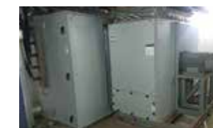
検査室空調機
