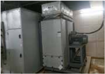
クリーンルーム空調機
