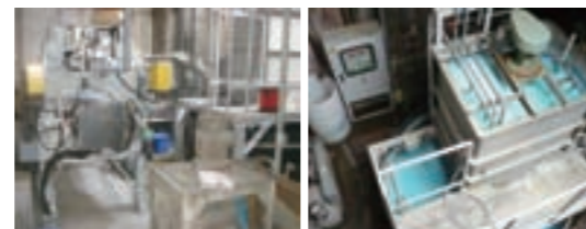
神奈川工場 廃アルカリ処理装置
