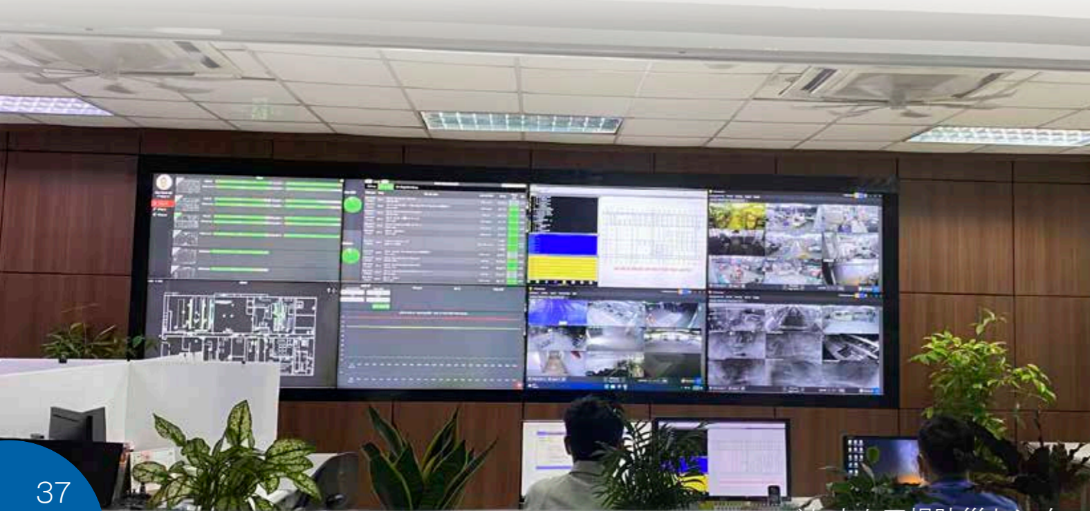
ベトナム工場防災センター
