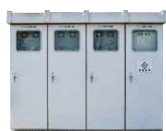
大電流変電設備
