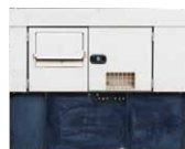
大型エンジン発電機
