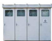
大電流変電設備
